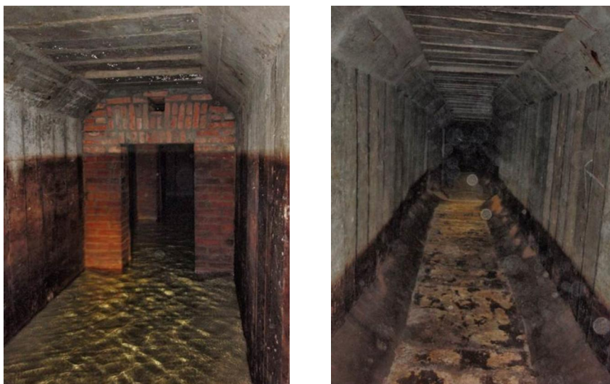
Rys. 10. Z lewej widok śluzy pod zachodnią częścią północną skarpy – widoczna woda na dnie tunelu oraz ślady historycznych lub okresowych poziomów jej występowania. Z prawej widok na tunel biegnący wzdłuż północnego zbocza skarpy – widoczny poziom maksymalnego zatopienia tunelu [9].
