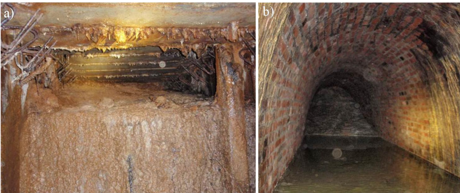
Rys. 13. a) widok przodka niedokończonego tunelu pod dziedzińcem (za zieloną strzałką wg rys. 11 – widać stożek napływowy z zawodnionego piasku, zjawisko to miało charakter nagły o czym świadczy zasięg stropu już wykonanego w stosunku do położenia prowizorycznej obudowy (na pierwszym planie, b) widok na wschód w kierunku owalnego ceglanego tunelu wzdłuż skrzydła północnego – w głębi widoczne zawalenie znajdujące się bezpośrednio pod miejscem katastrofy, na ścianach widoczne wybrzuszenia i deformacje ścian tunelu, dno tunelu zalane (fot.: T. Godlewski).
